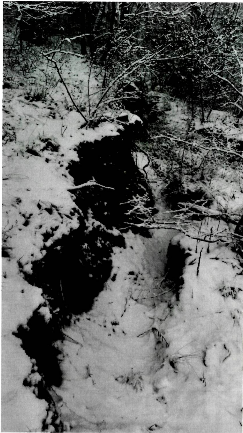
Северо-восточный борт оползня. Оползневые трещины.
